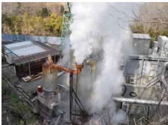
わいた会地熱発電所
