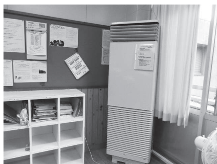
教室に設置された冷房機
