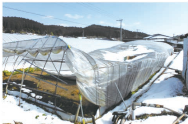
雪害によるパイプハウスの倒壊
