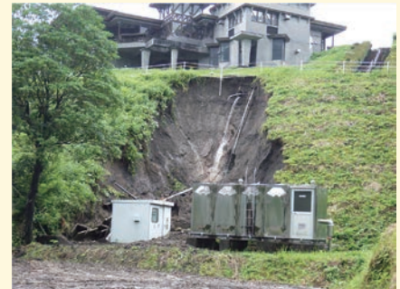
町道木魂館線災害現場
