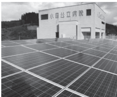
小国公立病院に設置した太陽光発電システム
