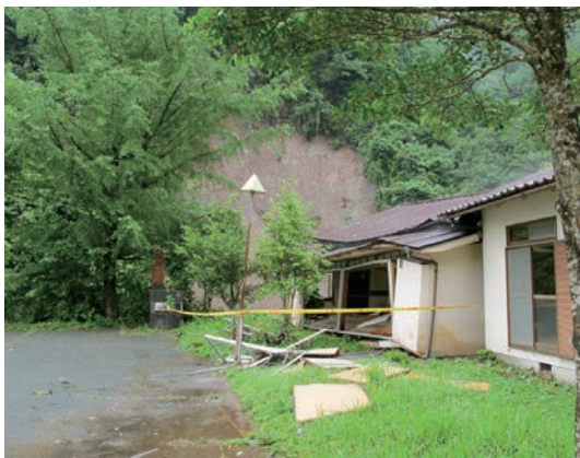
被災した旧下城小職員住宅
