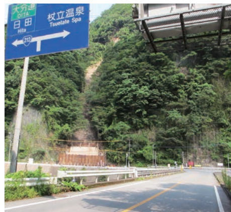
被災した国道212号線
