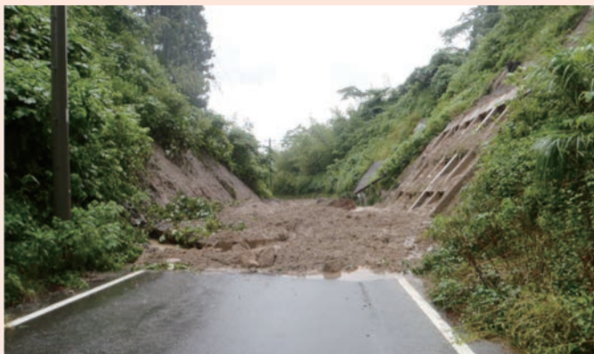
西廻り農道法面の崩落(北河内付近)
