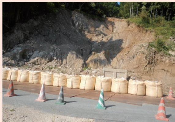
林道赤鹿線崩落現場
