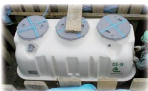
合併処理浄化槽
